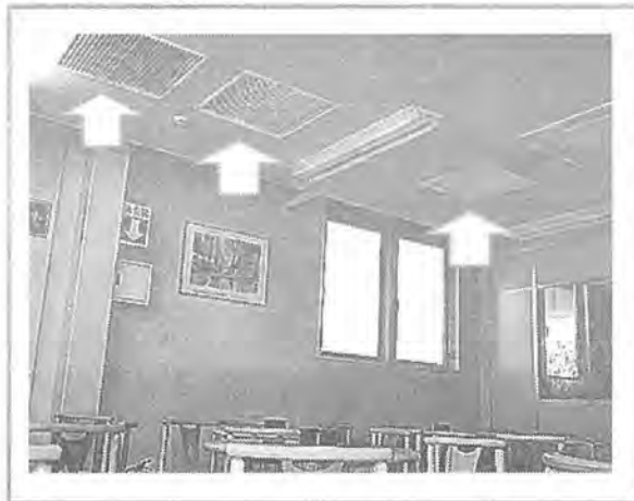
・天井の吸気口
