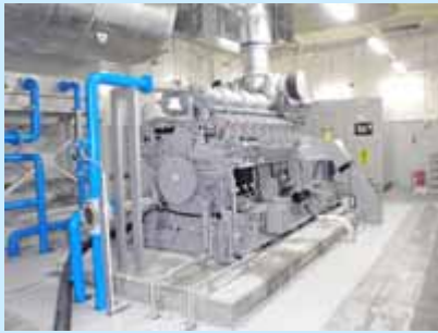
新設した 2ディーゼル発電機
